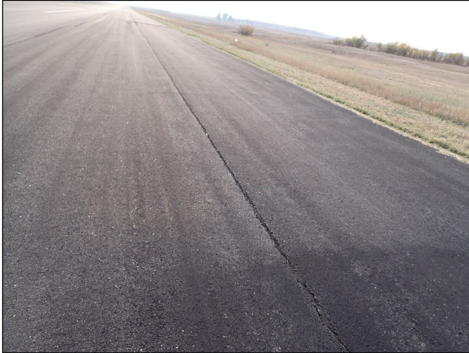
RW13-03-35: L&T Cracking
